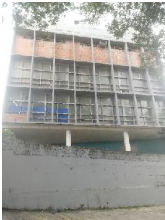
Figura 15 – Acesso que ligava diretamente o edifício à praça foi interrompido através de um muro de alvenaria. Fonte: Acervo do grupo, 2018.
