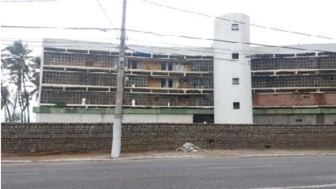
Figura 3: Estado de degradação do HIRM avançando. Fonte: Monique Maia, março de 2018.
