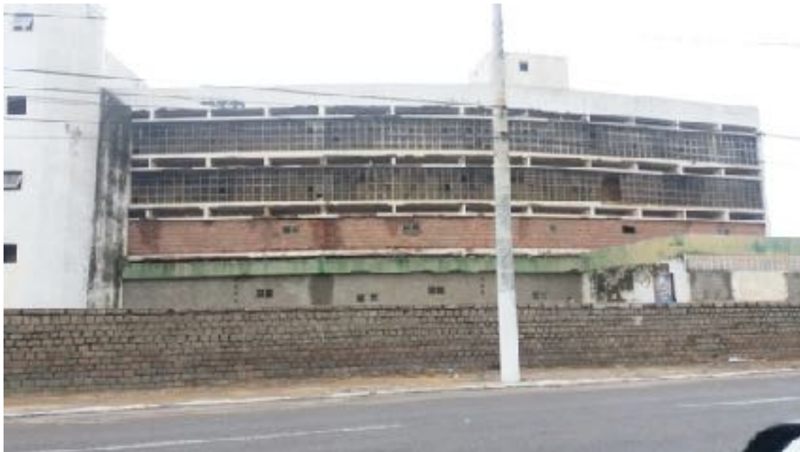
Figura 5: Estado de degradação do HIRM avançando. Fonte: Monique Maia, março de 2018.
