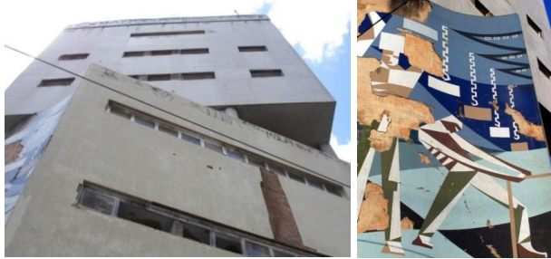
Figura 15: Detalhe da fachada sul deteriorada, Centro de Exportadores do Ceará.
