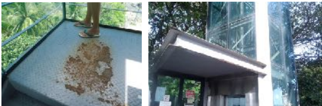
Figuras 20 e 21: Sinais de corrosão da estrutura metálica. Fonte: Natália Vieira, 2014; Natália Vieira, 2016.
