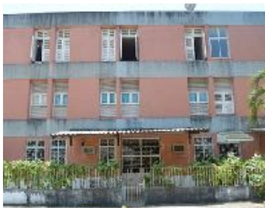
Figura 12- Alterações das esquadrias. Fonte: CAVALCANTE (2015).
