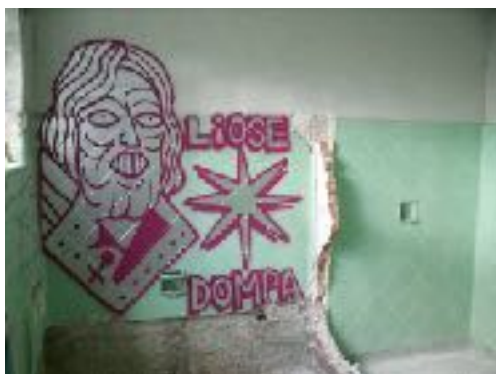
Figura 30 – Destaque para a pichação nos azulejos e na tinta da parede. Retirada dos registros de água na parede esquerda. Nesta mesma parede, mais azulejos quebrados e danificados. Fonte: DPPC, Novembro, 2017
