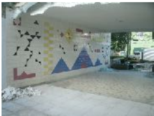
Figura 16 – Ao fundo, estilhaços de vidro devido à quebra do blindex; remoção das arandelas de iluminação e luminária do teto. Nesta imagem, percebe-se com mais detalhes o novo piso de cerâmica inserido junto ao existente e a ausência de rodapé nesta parte. No canto superior esquerdo, observa-se o ponto de partida que dá início ao acréscimo da cobertura (citado na Figura 15). Fonte: DPPC, Setembro, 2017
