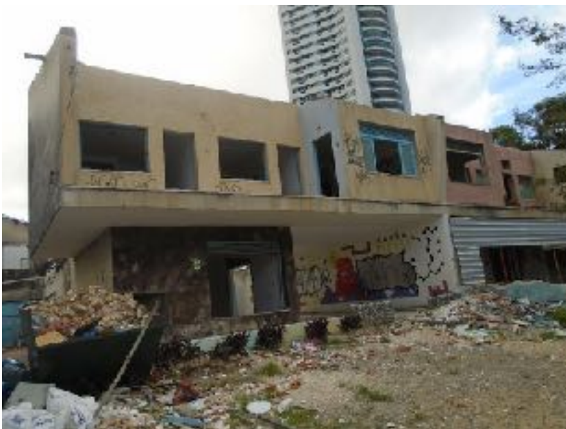
Figura 10 – Situação das Casas em fevereiro de 2018. Destaque para as depredações, pichações, entulhos, remoção do peitoril, venezianas, portas. Fonte: DPPC, 2018.
