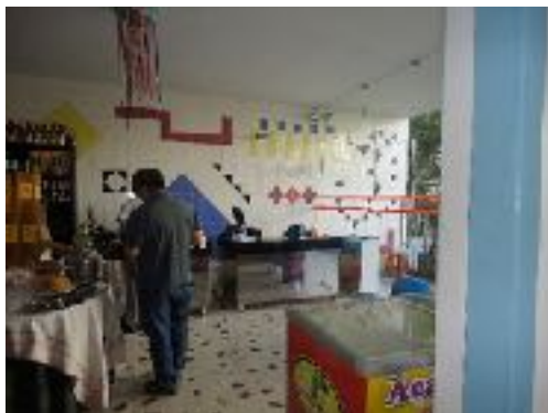
Figura 14 – Novo uso da edificação: Padaria Capela. Instalação de blindex no terraço interferindo na fluidez espacial da edificação. Obra irregular denunciada. Fonte: DPPC, Maio, 2016
