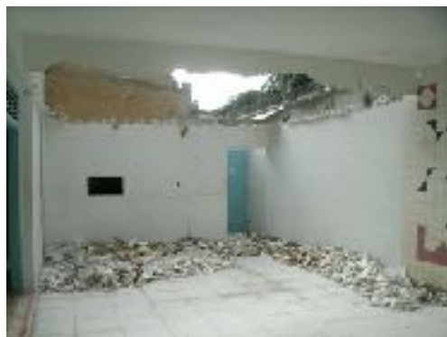
Figura 17- Forro de gesso quebrado; entulhos ao chão contendo muitos pedaços de placa de gesso e mangueiras. Destaque para a parede construída ao fundo no antigo limite do quarto de costura; buraco retangular rasgado na parede; marcas da instalação do ar condicionado; à direita, acesso criado a banheiro também construído posteriormente. A parede amarela é pertencente ao projeto original, onde apresenta os indícios da remoção da cobertura e furos para passagem de instalações. Fonte: DPPC, Setembro, 2017
