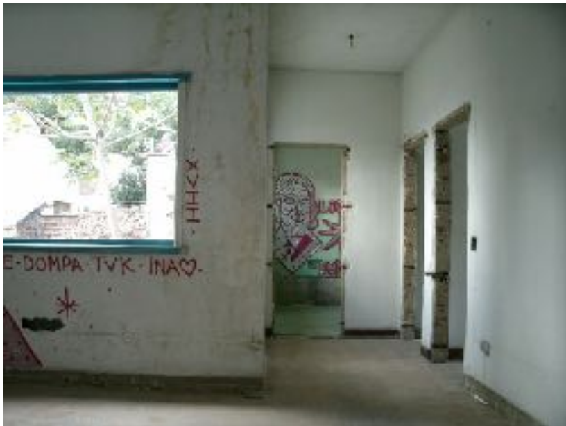
Figura 5 – Remoção do material do piso, portas e janelas. Ao fundo da foto, destelhamento e banheiro deprecado.
