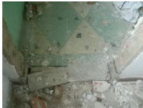
Figura 29- Soleira quebrada. Remoção do piso de madeira da sala de estudo. Grade da porta e porta de entrada do banheiro foram removidas. Fonte: DPPC, Setembro, 2017
