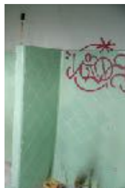
Figura 31 - Louça do banheiro removida. Em seu lugar, indícios de que houve fogo no local. Pichações na parede; interruptor e ralo removidos. Fonte: DPPC, Novembro, 2017
