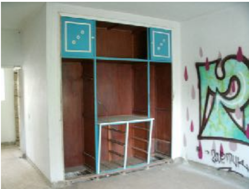
Figura 8 – Antigo quarto da residência, sem revestimento do piso, remoções das portas dos armários, pichações. Fonte: DPPC, 2017.
