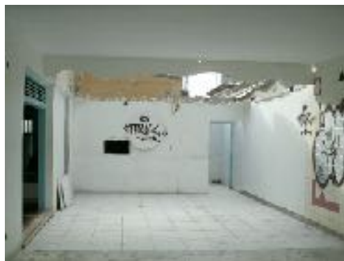
Figura 19 – Mais pichações no imóvel; Ao fundo, remoção da porta que indicava um banheiro posterior ao projeto original (Figura 17). Observa-se, nesta mesma área, que a mesma cerâmica do piso também foi colocada em algumas paredes. À esquerda, soleira quebrada e remoção da porta, permanecendo apenas a veneziana. Fonte: DPPC, Novembro, 2017
