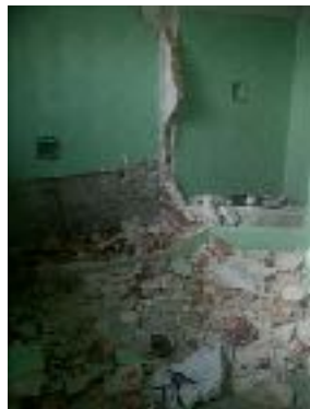
Figura 28 – Banheiro bastante depredado com presença de entulhos, comprovando o abandono da casa. Remoção da banheira e da porta do box. A parede divisória entre o box e a banheira, foi destruída. Os azulejos da parte superior à divisória também foram removidos/quebrados. Fonte: DPPC, Setembro, 2017
