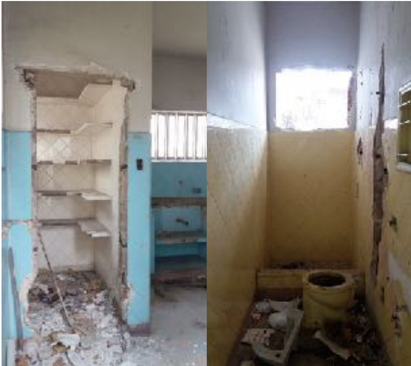
Figura 6 e 7 – Depredações da cozinha, área de serviço e banheiro. Fonte: Maria Luiza Freitas, 2018.
