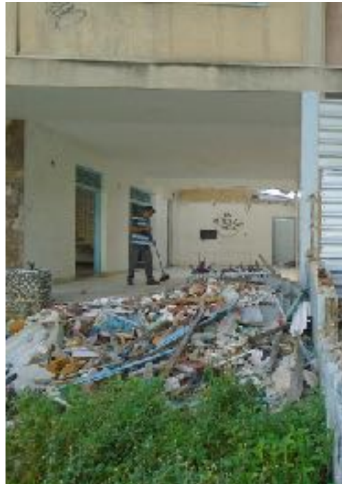
Figura 21 – Constata-se o aumento de entulhos na parte frontal do imóvel, com aparentes resquícios dos travamentos removidos do peitoril da varanda do pavimento superior. Ausência das duas portas de acesso à sala; outro ângulo da destruição do muro que divide as duas casas; jardim frontal sem cuidados.
