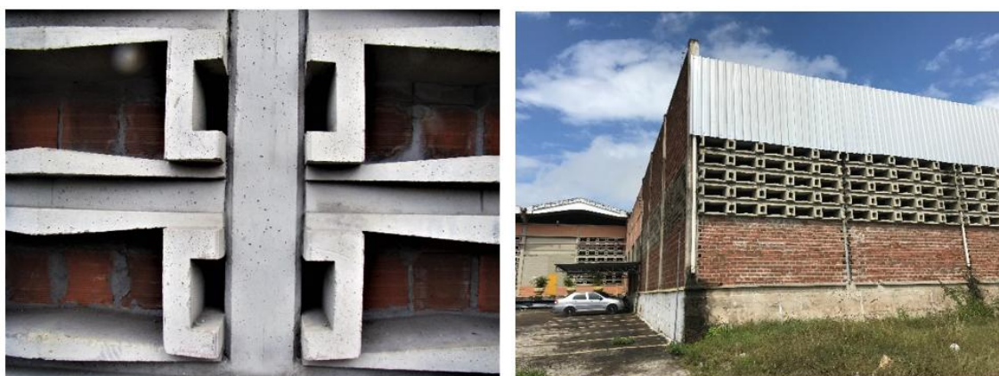
Figura 12 – Pannel com descaracterizações realizadas no edifício. Fonte: LEITE J. (2018)
