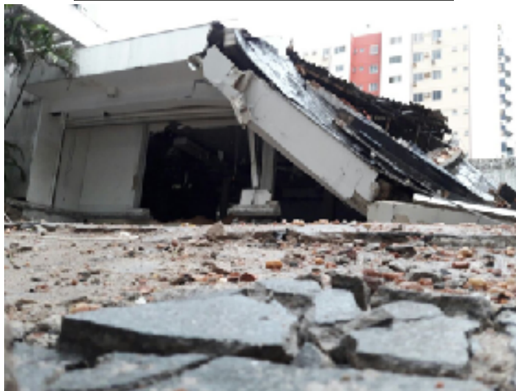
Figura 2 - Desabamento da laje da Residência Benedito Mutran (9 jan 2018). Foto: Diego Feitosa.
